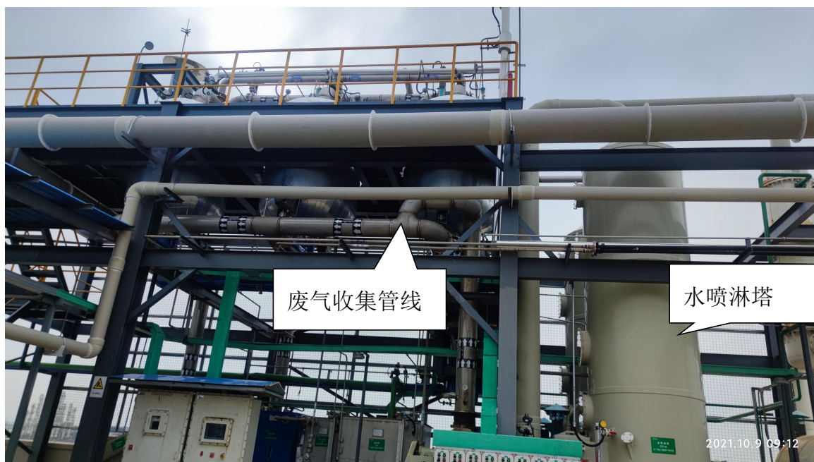
图 4.1-10 废气处理装置
