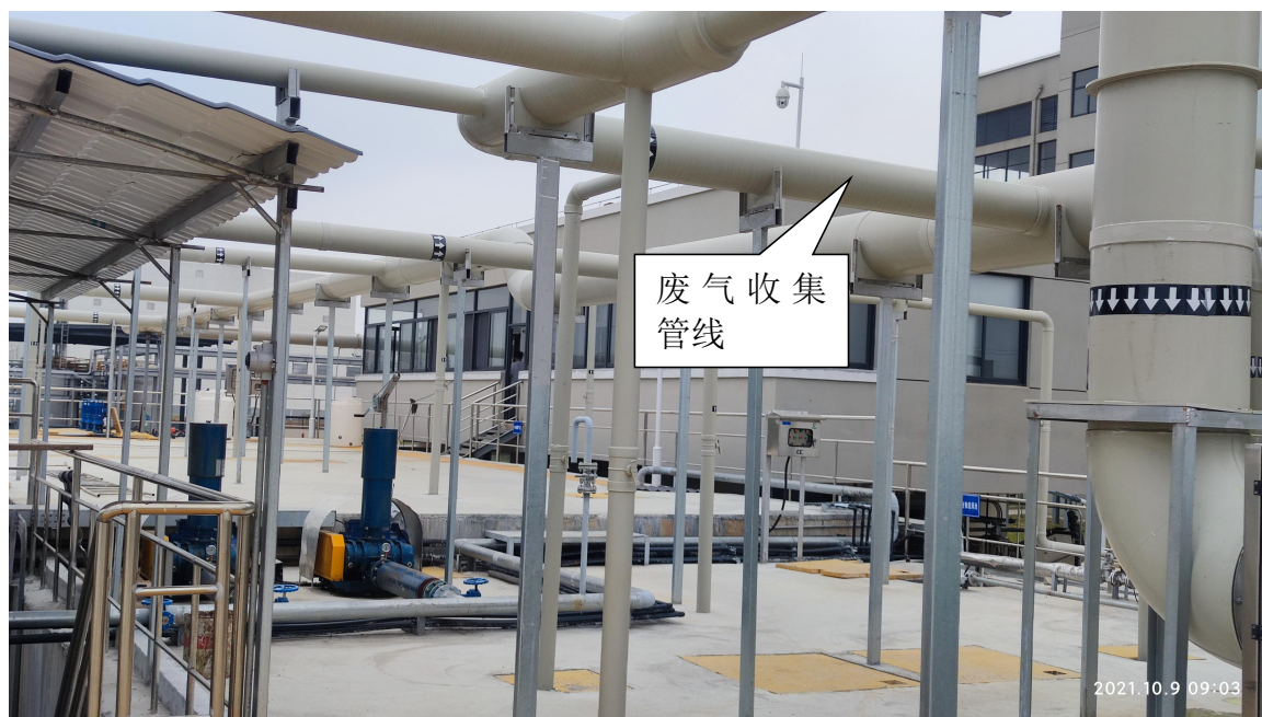
图 4.1-8 废气收集管线
