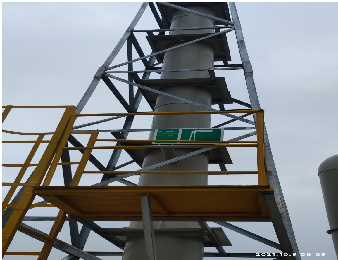
图 4.1-11 排气筒、检测平台、标识牌
