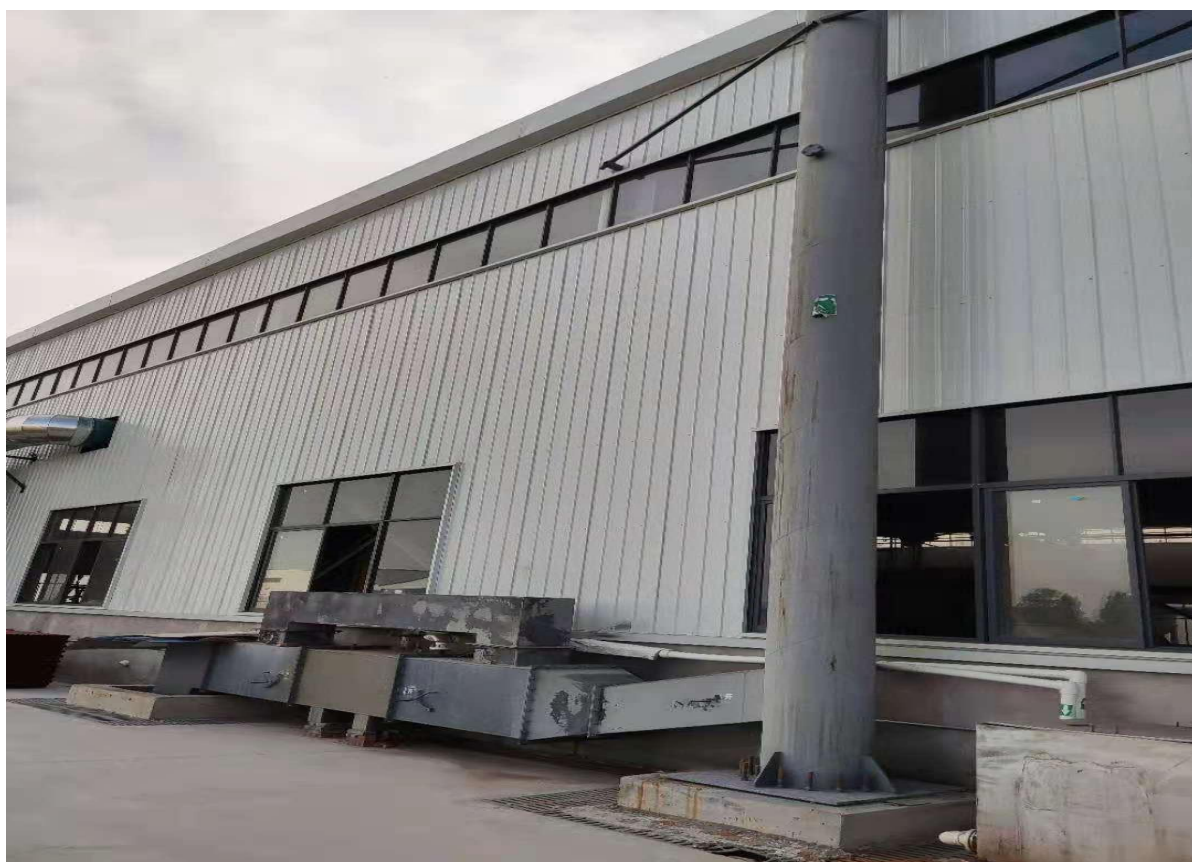
镀锌炉废气排气筒
