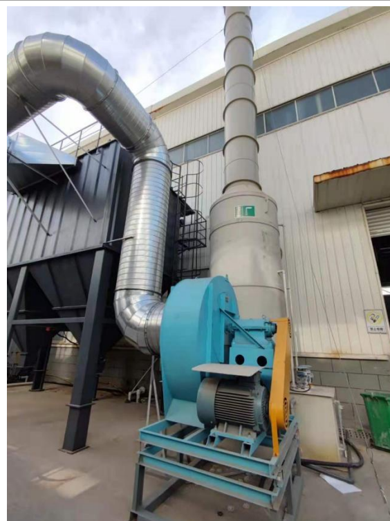
热镀锌废气排气筒
