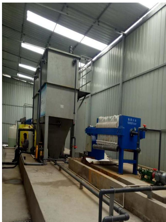
生产废水治理设施
