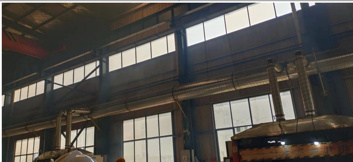
焊接废气收集设施
