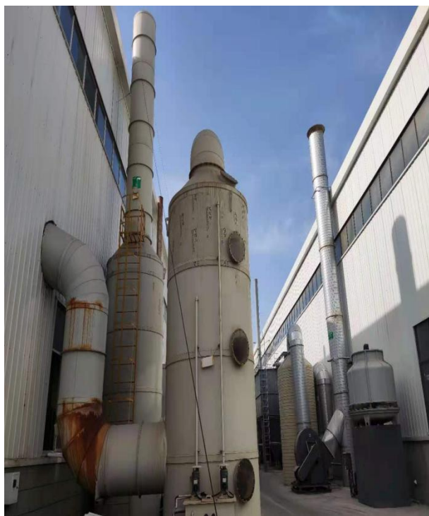
酸洗废气排气筒
