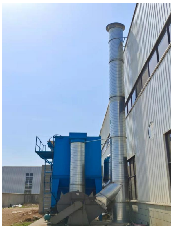
焊接废气处理设施
