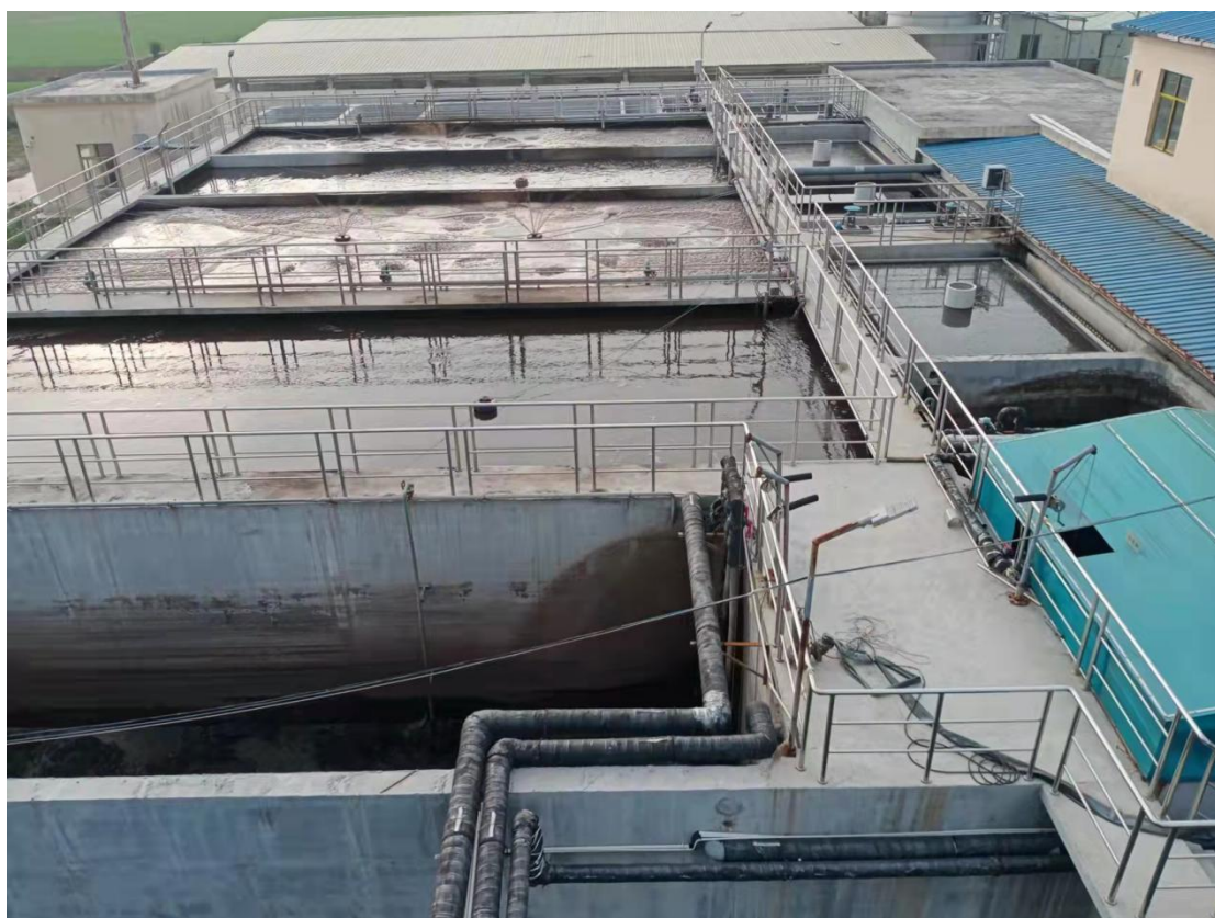
污水组合池全景
