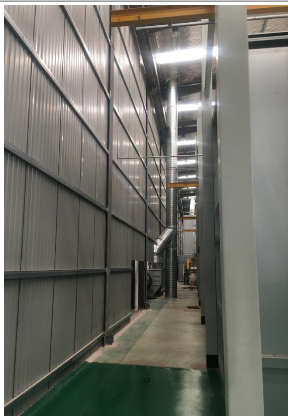
喷漆废气排气筒
