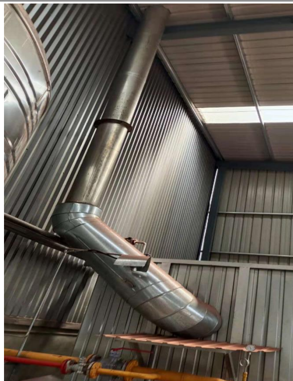
热水炉废气排气筒
