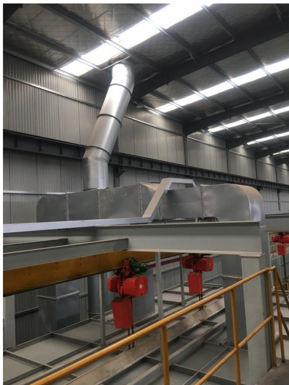
车间内废气排放管道
