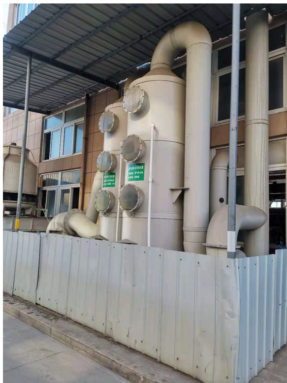
废气处理设施
