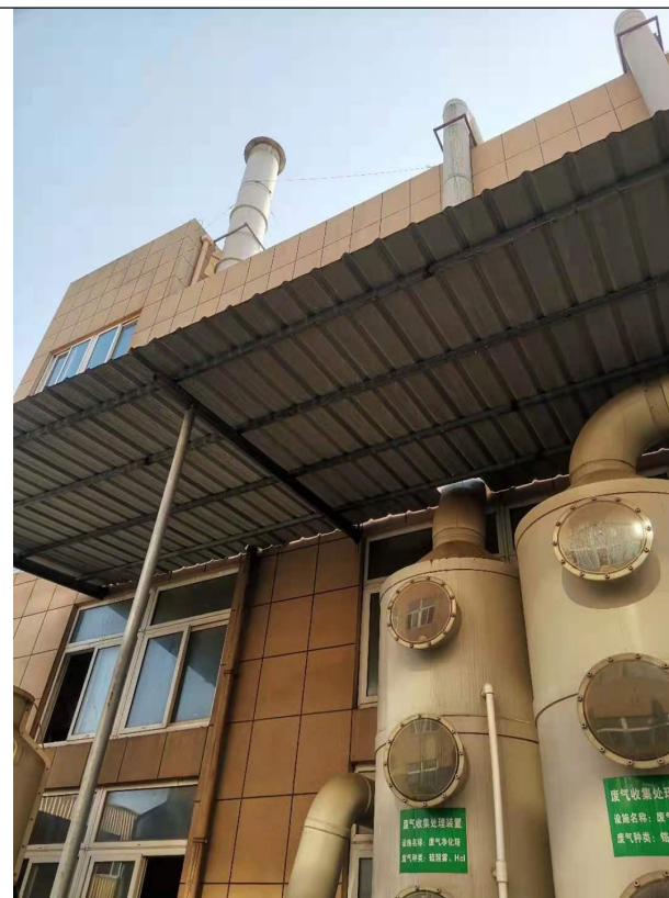
废气处理设施
