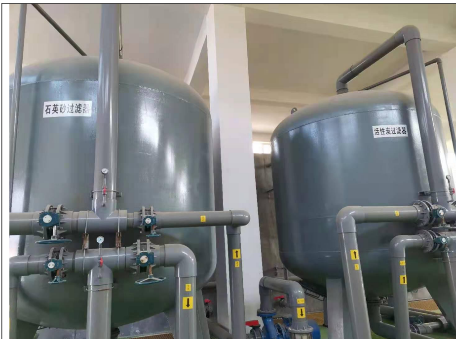
废水过滤设施
