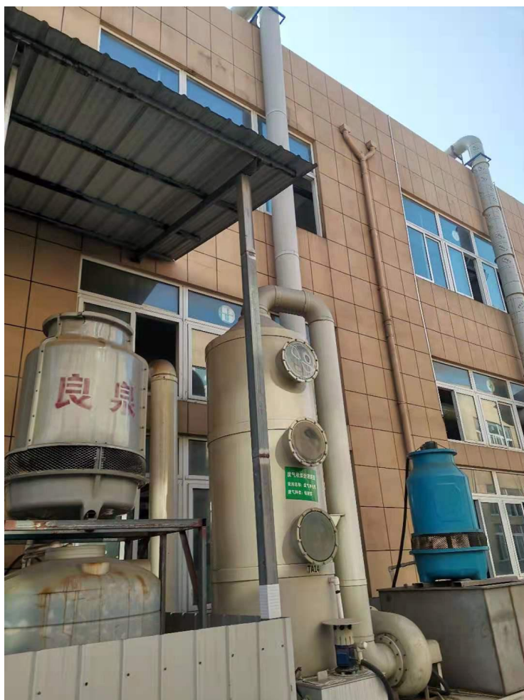
废气处理设施
