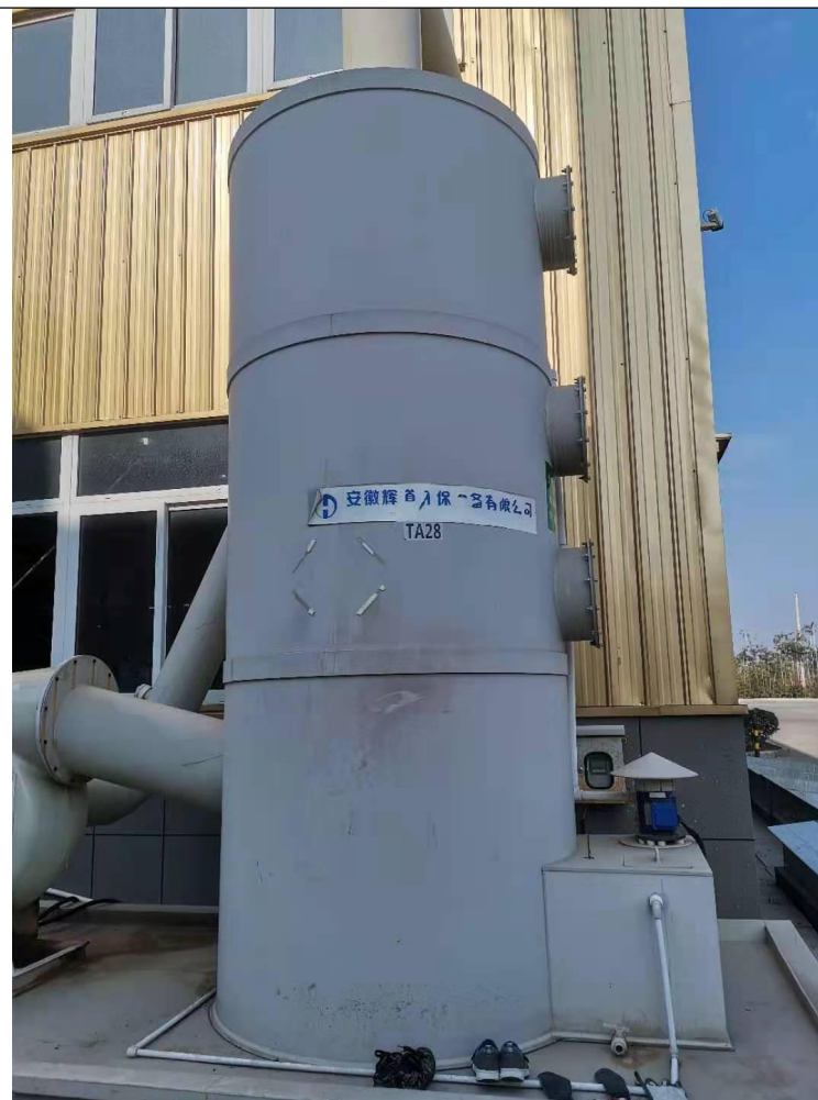
废气处理设施
