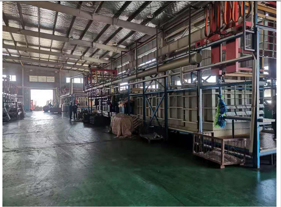
废气收集管道
