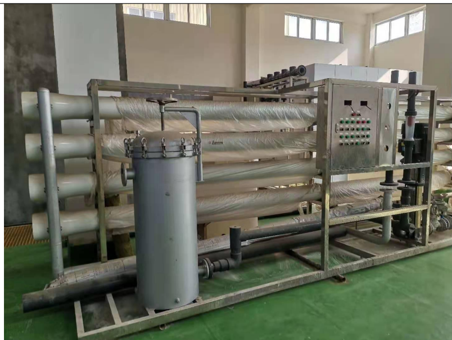
废水过滤设施
