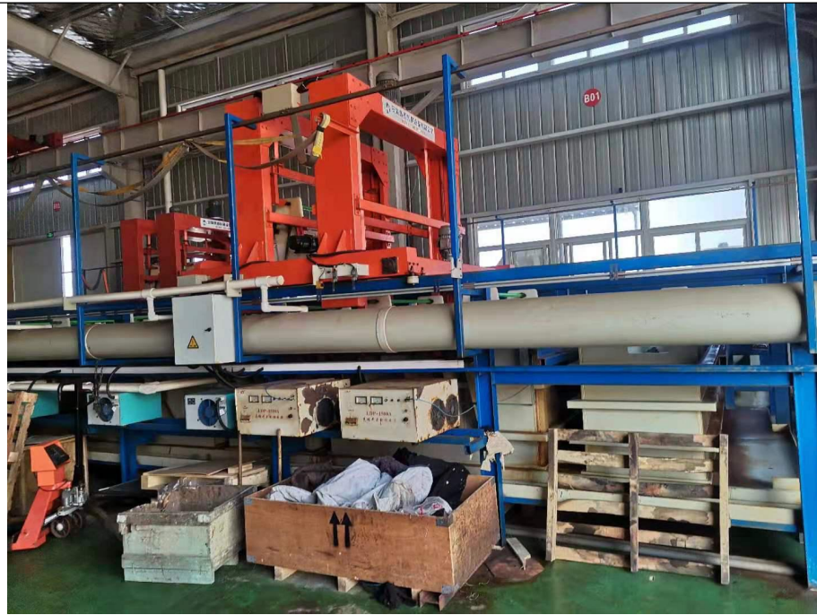
废气收集管道
