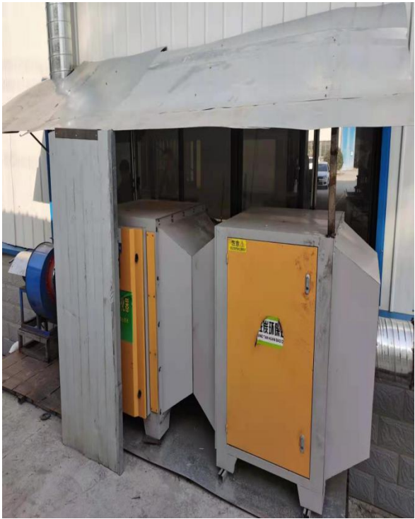
一级活性炭吸收装置+UV光解装置
